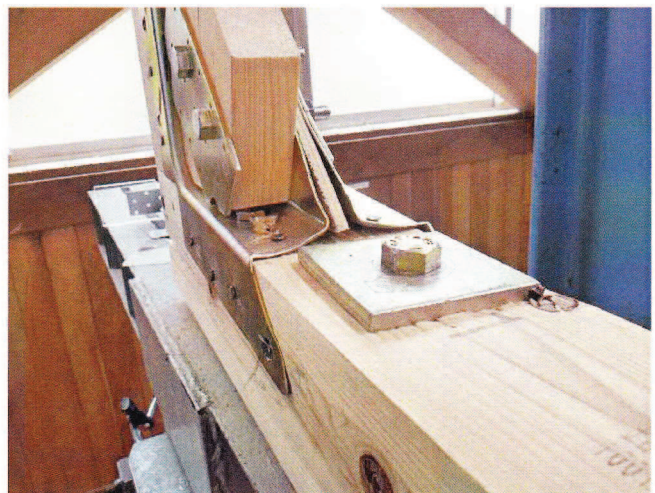
写真4.3.6 座金のめり込み
