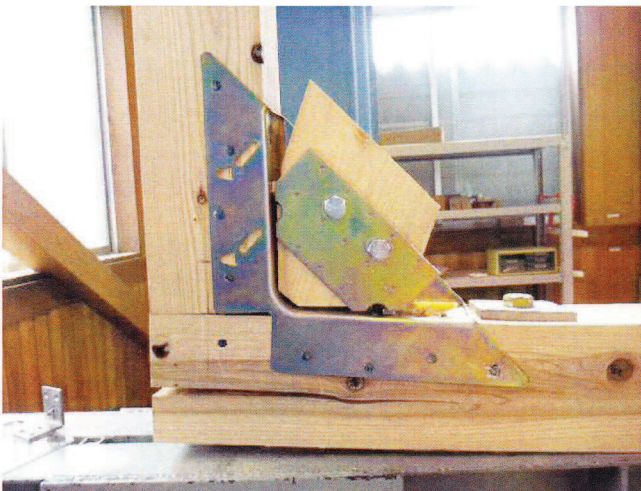
写真4.3.3 釘による土台の割れ
