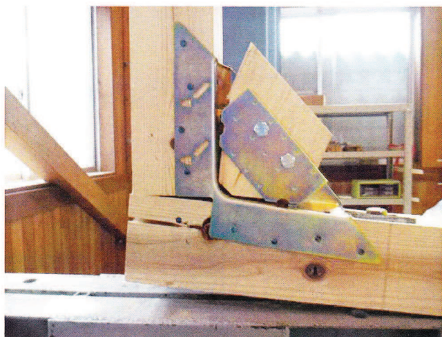
写真4. 2. 5 土台の浮き上がり
