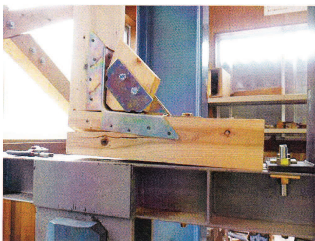
写真4.1.3 釘による土台の割れ
