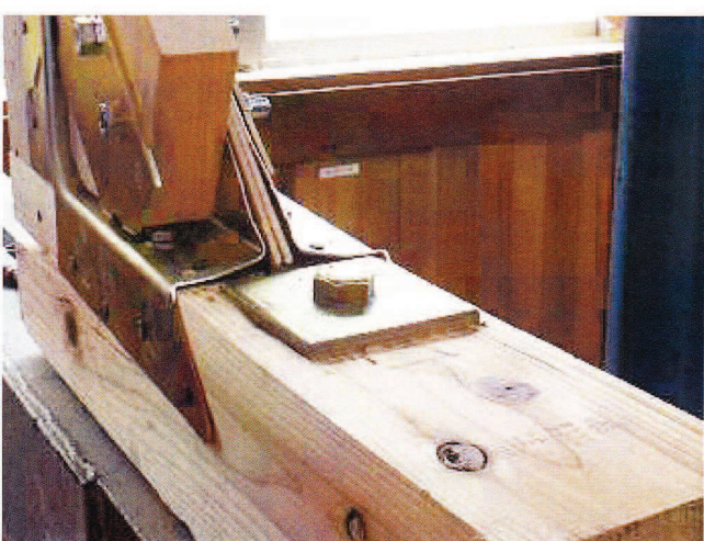
写真4.1.6 座金のめり込み
