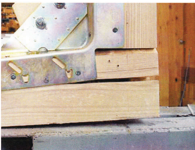
写真4.3.5 土台の浮き上がり
